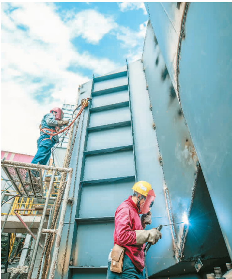
近日，在安徽省马鞍山市，中国宝武马钢股份特钢公司除尘环保设施改造升级项目正加紧施工。罗继胜摄（人民视觉）
