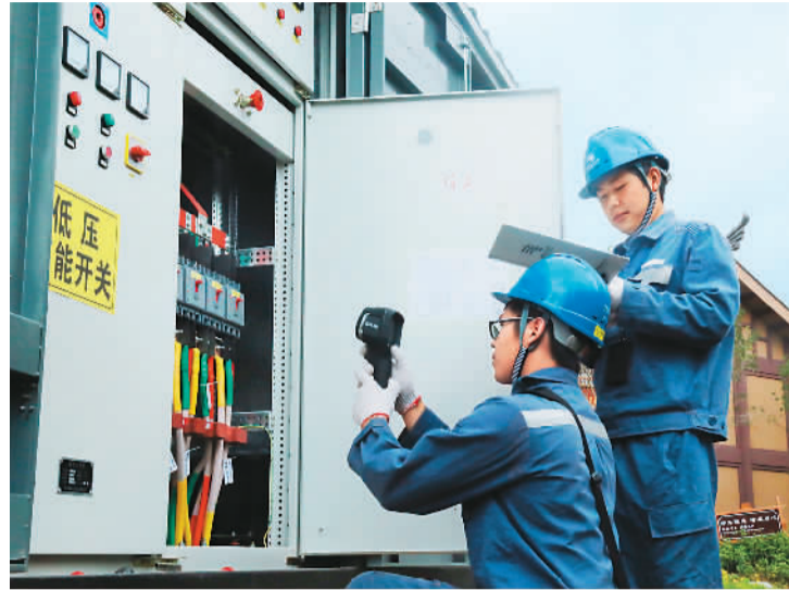
近日，南方电网贵州省铜仁市松桃苗族自治县供电局对110千伏等级以下变电站开展夜间巡视，全力保障迎峰度冬期间电网和设备安全稳定运行。图为工作人员正在巡视设备。田杰摄（人民视觉）
