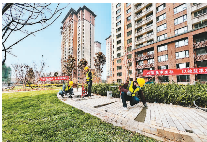
11月17日，中铁二十二局集团参建的河北省重点民生工程——保定市主城区城中村改造工程王七里店安置区项目一期项目落成。本次完工项目涉及土地约1.5万亩，11个安置区，共152栋安置房，惠及17个村，6000余户、2.4万人。整项工程分四期进行，新建安置区63个。图为建设者在小区内进行施工作业。李建军摄（人民视觉）
