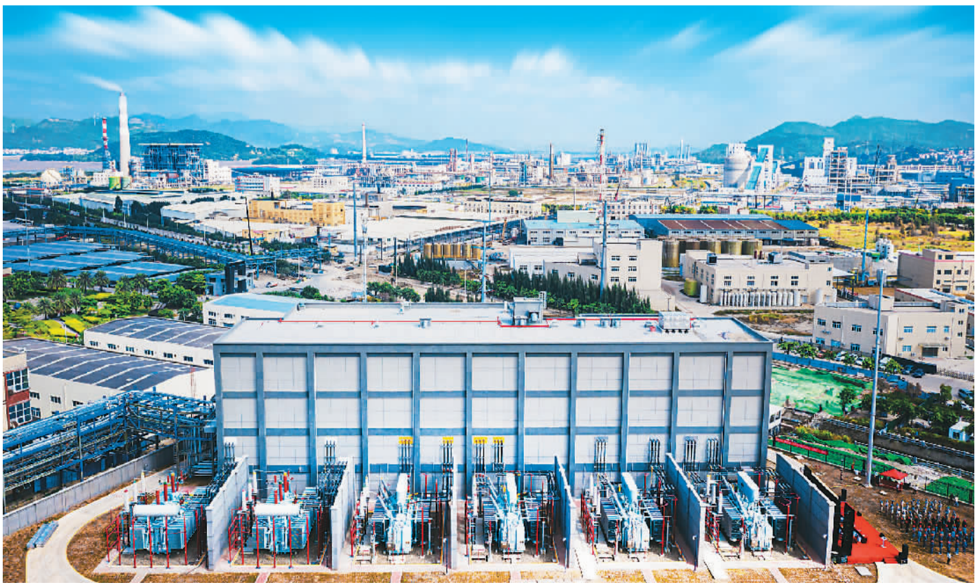
福建福清220千伏西部输变电工程近日建成并顺利投运。该工程为目前国内单体容量最大的输变电项目，总投资3.2亿元，一次性建设6台240兆伏安主变压器，建成之后有助于提升当地电网供电能力，支撑当地产业跨越式发展。
