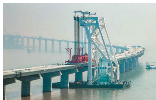
深中通道海上非通航孔橋最後一片混凝土箱樑完成架設。
