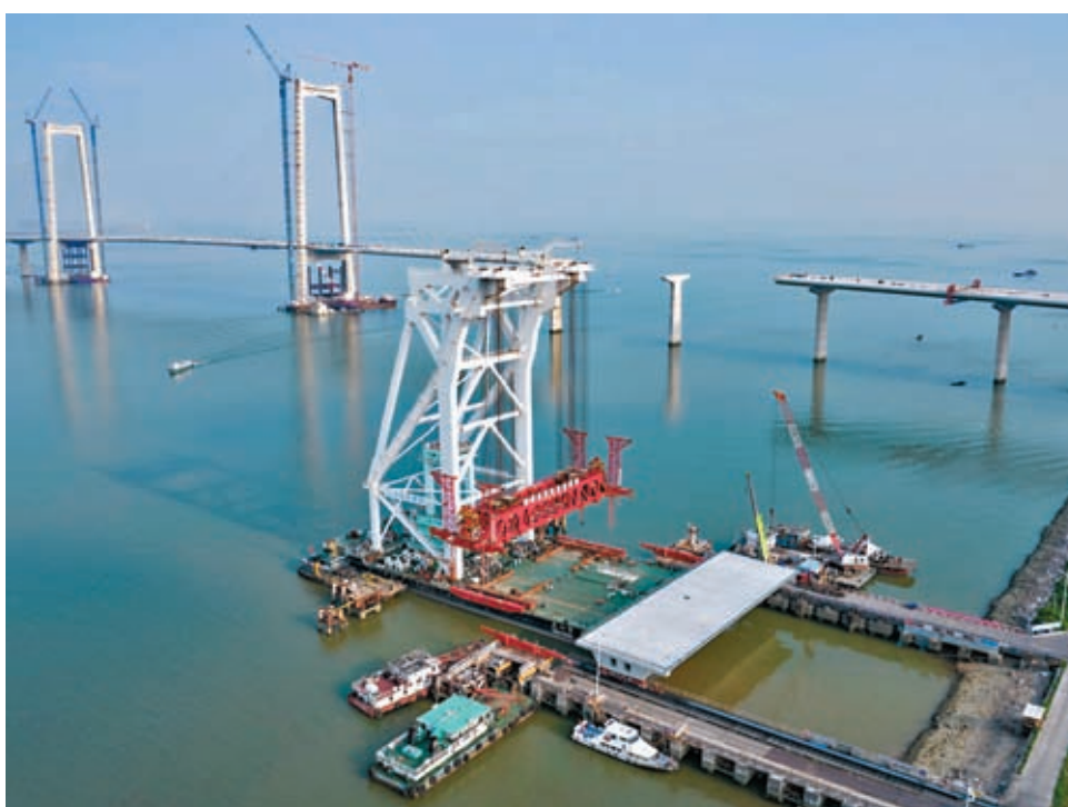
◆10月8日，廣東省中山市，一片混凝土箱樑準備運送上運架一體船「天一號」。當日，隨著第155片60米混凝土箱樑預製完成，粵港澳大灣區核心工程深中通道混凝土箱樑全部預制完成。 資料圖片
