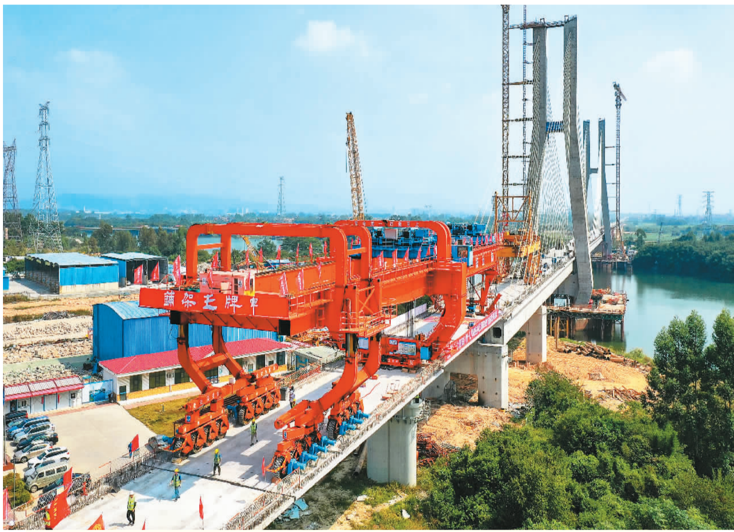
近日,中铁五局承建的广汕铁路铺架施工最后一孔900吨箱梁成功架设在广东广州增江特大桥桥墩上,标志着全线箱梁架梁完成。设计时速350公里的广汕铁路全长206.2公里,途经广州、惠州、深汕合作区、汕尾,全线预计2023年建成通车。通车后,广州到汕尾运行时间将由现在的2小时左右缩短至40分钟左右,将有力助推粤东地区加快融入粤港澳大湾区。图为施工人员操作架桥机架设箱梁。
