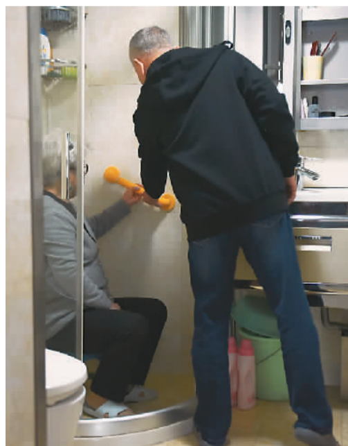
图为10月26日，浙江省杭州市余杭区79岁张季雄老人家的浴室里，正在安装扶手。 孔亚鲁摄（人民视觉）
