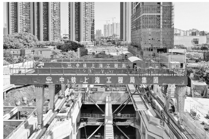
10月26日，施工人员在广州地铁11号线南石路施工区吊装铁排(无人机照片)。
