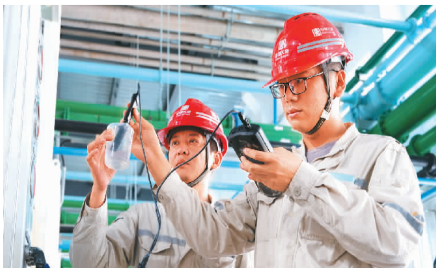
▲大唐东营发电有限公司采用反渗透法对海水进行淡化处理，其海水淡化系统淡水产量达到8640吨/日，投运后累计产水250余万吨，较好解决了企业用水需求。图为近日，工作人员对海水淡化设备进行检测。郭俊峰摄（人民视觉）
