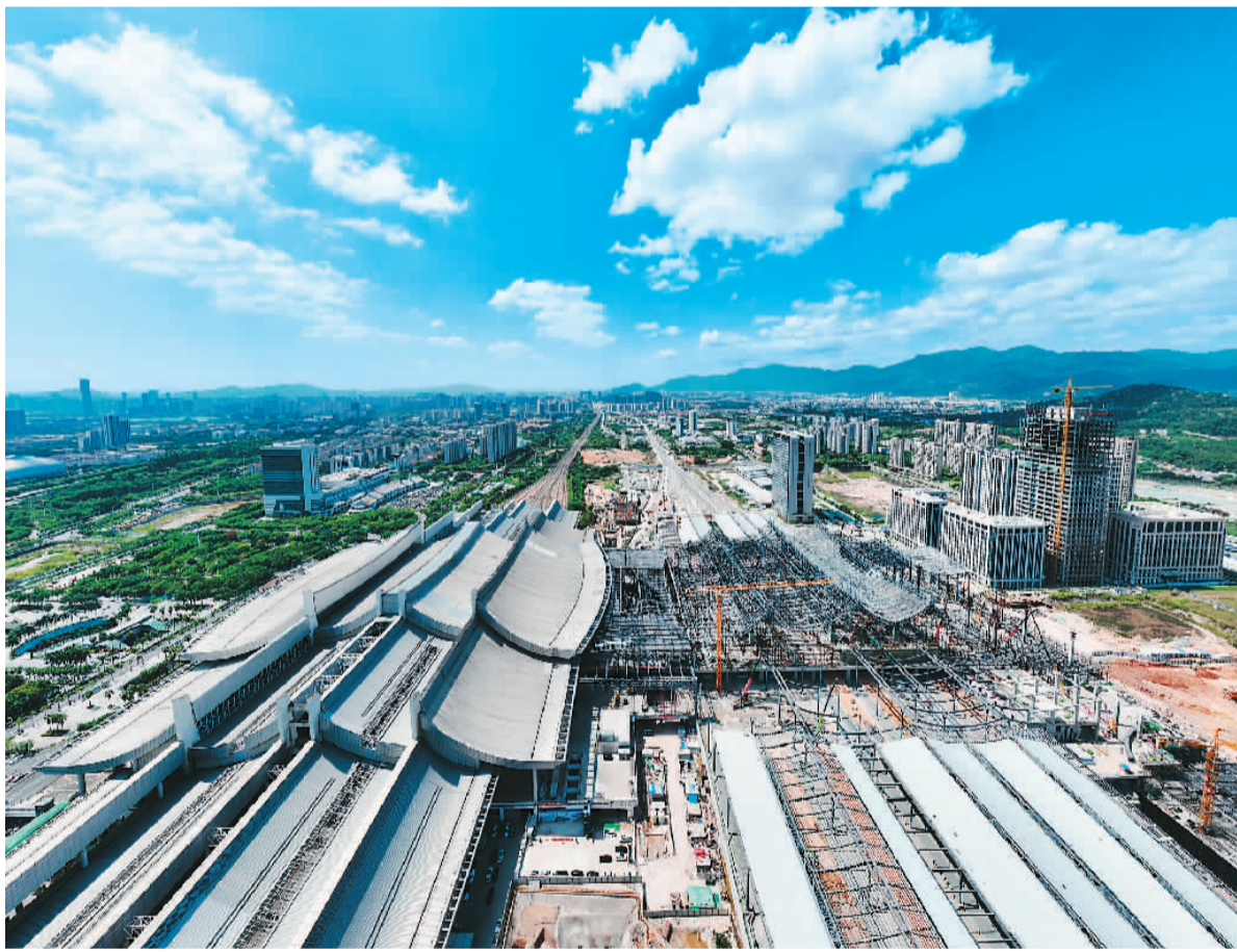
中国首条跨海高铁——新建福州（门）铁路不久前全线铺轨贯通，目前铁路沿线站房等工程正加紧建设。新建福州铁路设计时速350公里，正线全长277.42公里，建有湄洲湾、泉州湾、安海湾3座跨海大桥，全线共设厦门北站、福州南站等8座车站。铁路建成通车后，福州、厦门两地将实现“一小时生活圈”，厦门、泉州、漳州闽南“金三角”将形成半小时交通圈。图为10月9日拍摄的由中铁建设承建的厦门北站主站房钢结构施工现场。 武冲摄（人民视觉）
