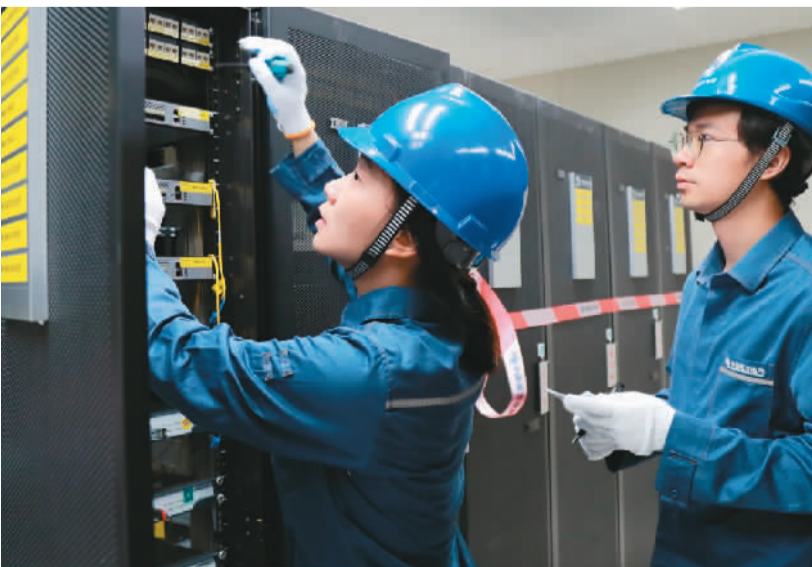
近日,贵州省兴义市供电部门完成了电网数智化运维系统建设,可通过“电子眼”远程监控系统对电网设备进行远程监控,保证了电网的安全稳定运行。图为南方电网贵州兴义市供电局技术人员正在对电网自动化机房的设备进行巡检维护。
