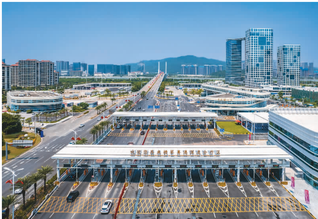
横琴粤澳深度合作区“二线”通道横琴大桥、横琴隧道、深井通道、横琴码头海关监管作业场所近日完成主体结构施工，正有序推进配套信息化工程建设，相关工程计划于今年12月底前完工。
