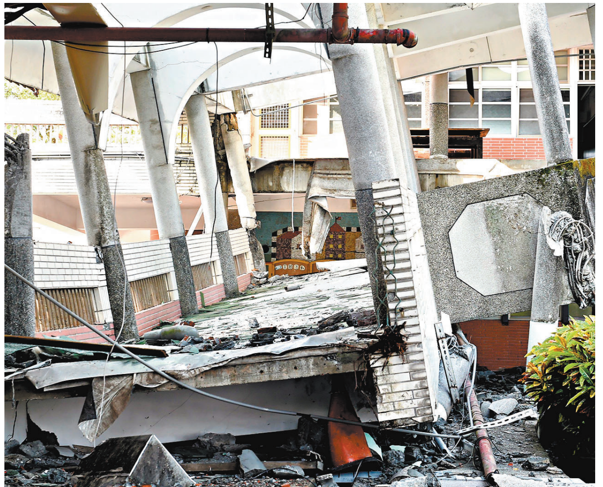
◆台灣花蓮玉里春日小學部分校舍被震塌。
