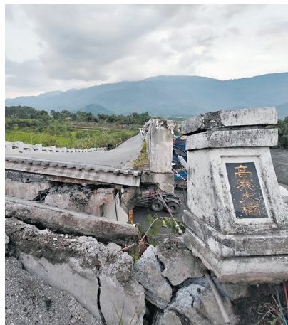
◆ 花蓮縣玉里鎮高寮大橋斷裂毀損。 中通訊
