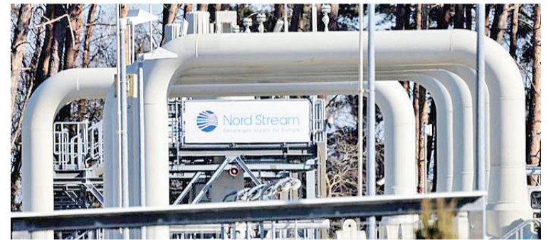
资料图：“北溪-1”天然气管道。
