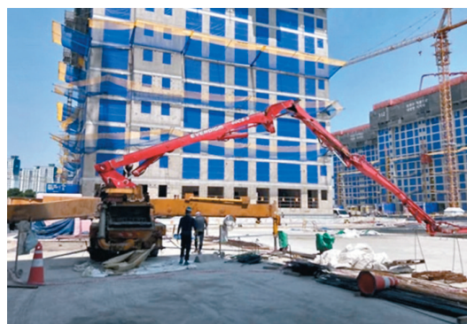
◆大宇建設旗下一位於光州的工地 5 月發生意外，一名中國工人死亡。網上圖片
