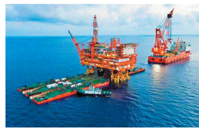
◆海洋工程駁船「海洋石油229」承載恩平15-1中心平台上部組塊完成重載轉移，組塊與導管架實現精準對接。網絡圖片
