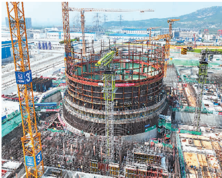
图为位于江苏省连云港市连云区的田湾核电站7号机组建设现场。
