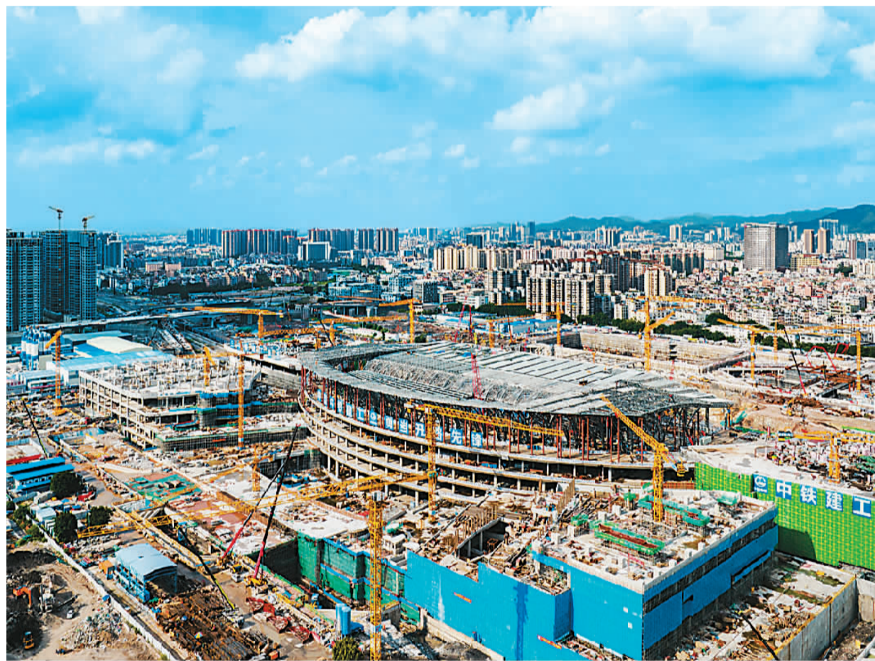
近日，广东广州白云火车站建设现场如火如荼，工人们正加紧施工。广州白云火车站是粤港澳大湾区的重点工程，该项目建成将成为具有岭南特色的大型综合交通枢纽。 图为建设中的广州白云火车站。 魏劲松摄（人民视觉）
