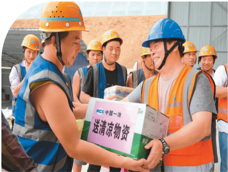
7月17日，融从高速公路一期工程广西壮族自治区融水县怀宝互通施工现场，工作人员向农民工分发矿泉水。 龙涛摄（人民视觉）
