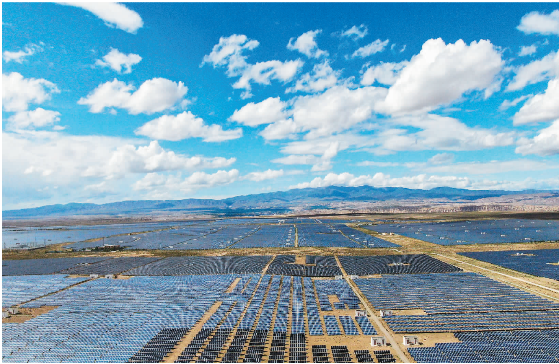
6月26日，无人机拍摄的青海省海南藏族自治州共和县光伏电站。
