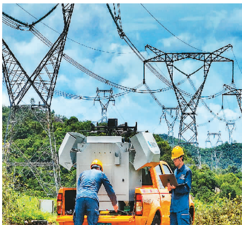
图为南方电网深圳供电局输电线路运维人员利用车载移动机巢起飞无人机对港供电线路400千伏核线进行特巡特维。李志杰摄(人民视觉)
