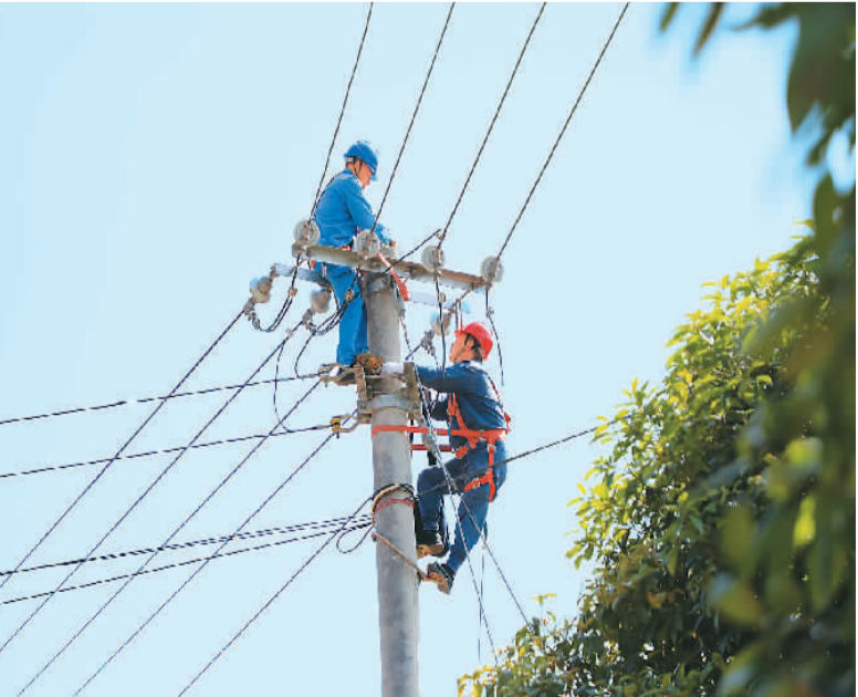
为保障“迎峰度夏”平稳用电,贵州省铜仁市供电部门近日积极组织电力工作人员开展农村电网巩固提升作业,通过巡视线路设备、改接负荷、智能监控等方式,强化农村电网运行管理水平,提升农村电网可靠供电能力。图为在铜仁市印江县新寨乡,南方电网铜仁印江供电公司工作人员正冒着高温巡检线路。 向世杰摄(人民视觉)
