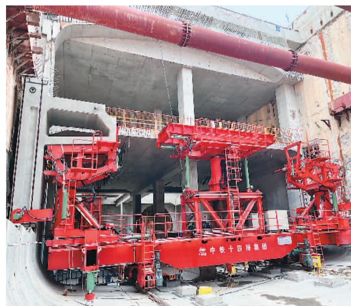
日前,深圳地铁3号线四期工程坪西站顺利完成第5环构件拼装,标志着首套全装配式地铁站拼装工艺及装备在深圳应用成功。全装配式施工技术由中国中铁科工集团、广州地铁设计研究院深圳分院联合研制。图为拼装机中层环作业现场。罗璞摄
