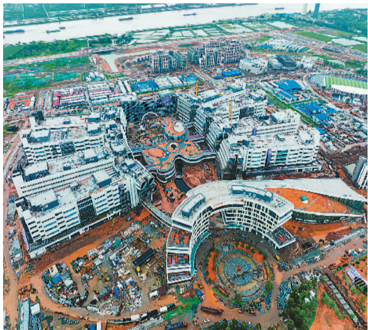
近日,位于广东省广州市南沙区的香港科技大学(广州)项目正紧张有序施工。香港科技大学(广州)项目是粤港澳大湾区建设的重点工程,建成后将成为促进粤港全面深入合作的科技创新平台和国际化人才培养基地。图为香港科技大学(广州)项目施工现场俯瞰图。
