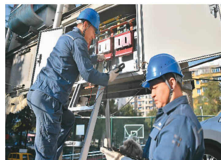
南方电网贵州铜仁供电局工作人员“五一”期间坚守岗位,巡查线路,确保安全供电,助力企业复工复产。图为日前在铜仁市九州物流园服务有限公司,铜仁供电局工作人员对变压器进行巡检。
