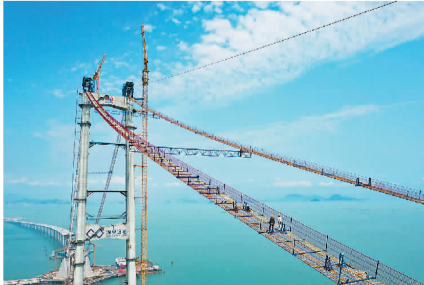
4月22日,中交二航局参建的深中通道伶仃洋大桥桥道实现全线贯通,标志着大桥空中通道搭建完成,为后续主缆架设奠定坚实基础。
