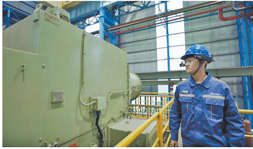
宝钢德盛车间工人戴着AR眼镜进行巡检。
