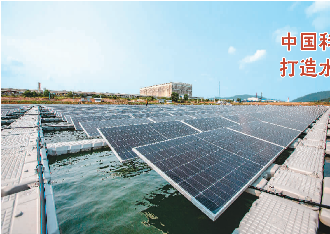
图为位于泰国罗勇府的水上浮式光伏电站。该电站由泰国万浦公司设计建设，中国华为公司提供光伏逆变器及智能数据采集器等重要设备和技术支持，计划今年内开始供电。 新华社记者 王腾摄
