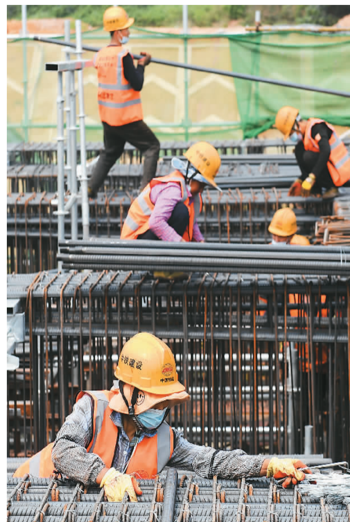
4月12日，贵南高铁南宁北站站房框架柱开始进行混凝土浇筑作业，车站主体工程建设正式启动。贵南高铁站房工程全面拉开。贵南高铁（贵州贵阳至广西南宁）是我国“八纵八横”高速铁路主通道包头至海口通道的重要组成部分。图为中铁建设集团工人在施工。新华社记者 陆波岸摄
