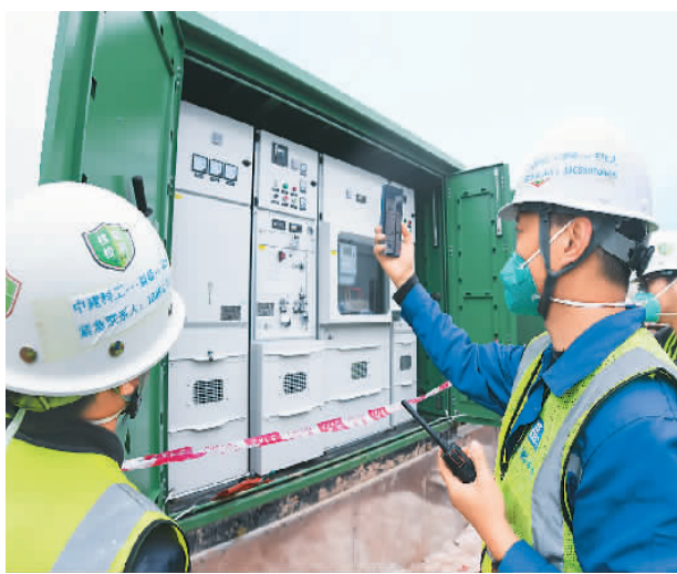
三月二十九日,在中央援港应急医院一期施工现场,中建科工工作人员与港方视频连线。新华社记者 梁旭摄
