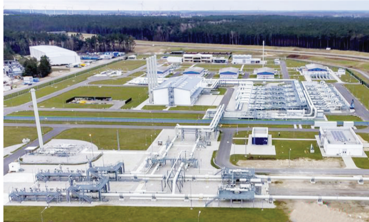
资料图:“北溪-2”天然气管道项目登陆设施的管道。
