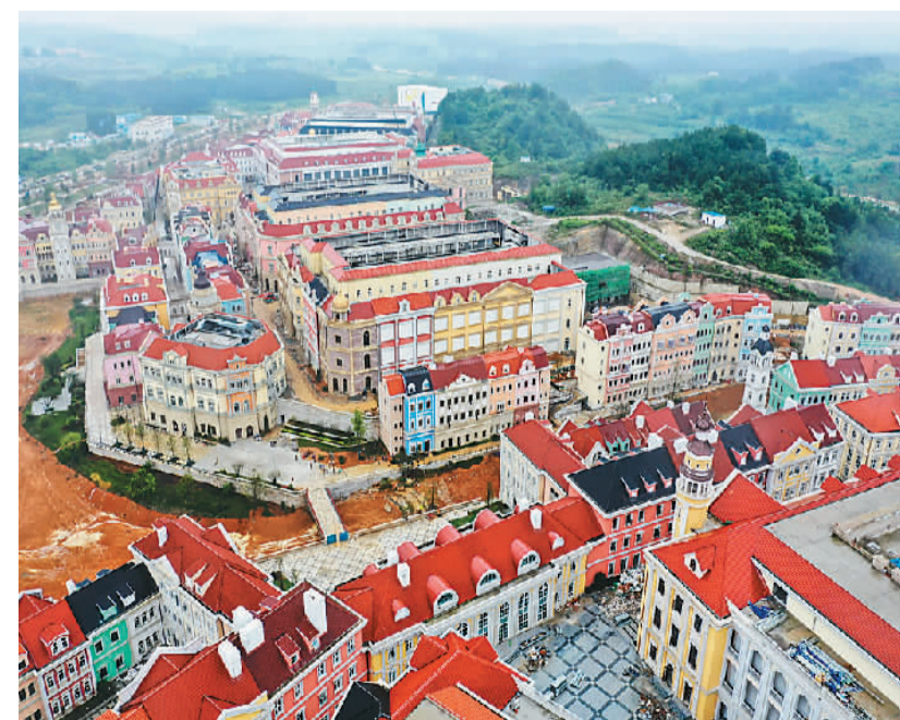
贵州省贵安新区“华为云”数据中心现场。
