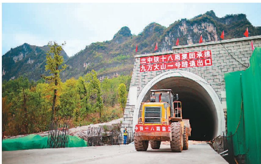
3月24日，贵南高铁最长隧道九万大山一号隧道顺利贯通。据了解，该隧道全长17012米，是全线重要控制性工程。贵南高铁设计时速350公里，是中国“八纵八横”高速铁路主通道包头至海口通道的重要组成部分。
