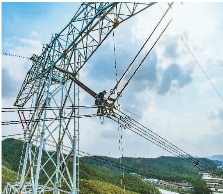
位于广东省江门市的500千伏五江甲乙线扩容改造工程近日顺利投运。工程投运后，从粤西地区输送来的电力将进一步满足粤港澳大湾区建设的电力供应需求。图为南方电网广东电网能源发展公司工作人员在进行投产前的检查验收工作。 温启文摄（人民视觉）
