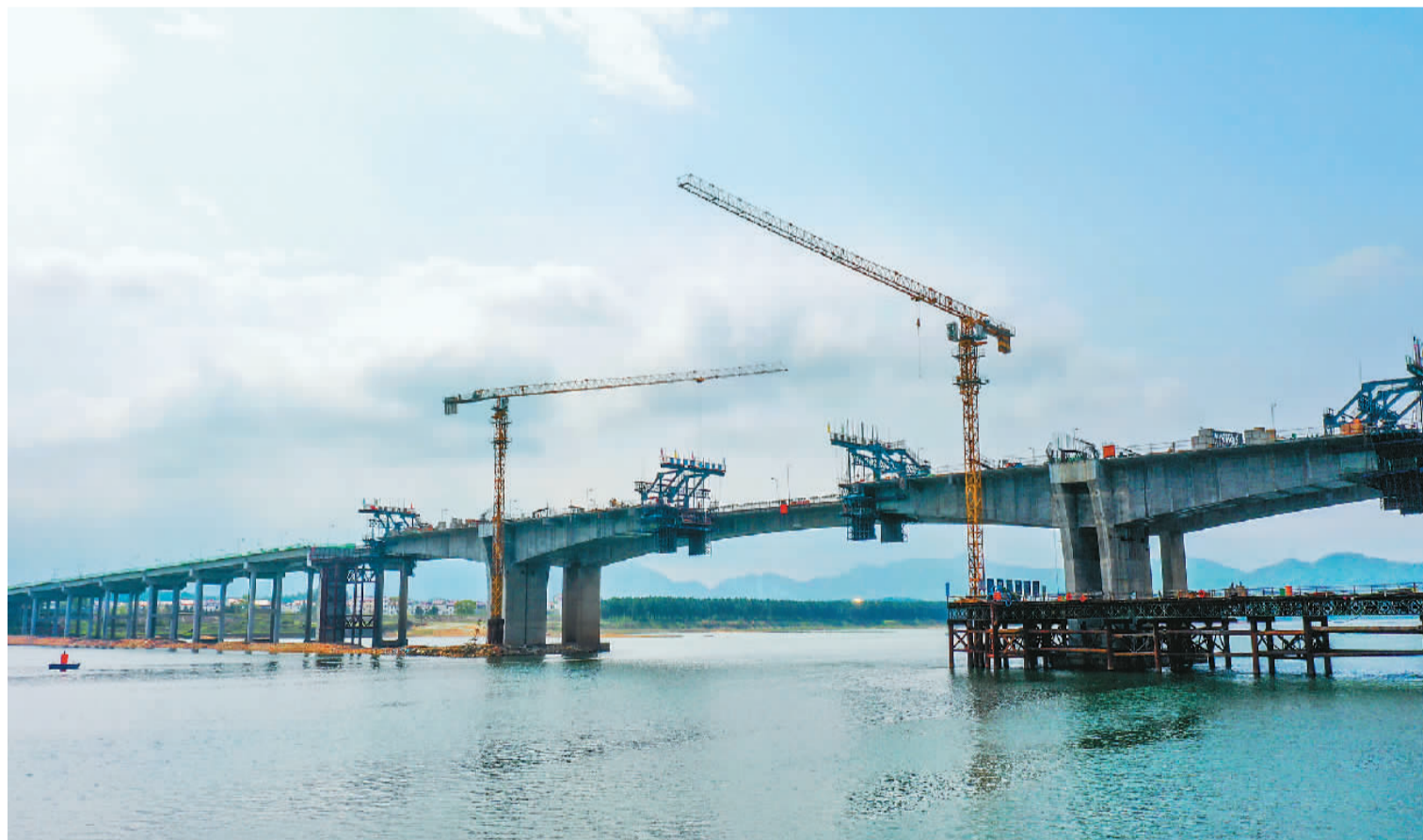
当前,江西省峡江县赣江大桥扩建工程项目正在加紧施工。江西峡江赣江大桥扩建工程全长1495米,作为G322国道的重要组成部分,大桥通车后将有力提升周边地区人流、物流方面的互联互通,对当地经济高质量发展起到有力推动作用。图为赣江大桥扩建工程施工现场。陈福平摄(人民图片)
