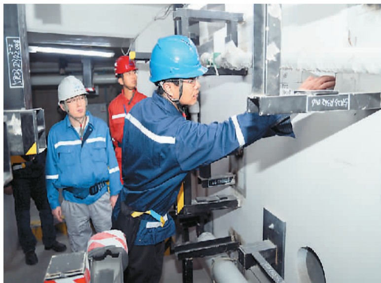
邢继(前右一)在华龙一号全球首堆福清五号机组内部查看设备情况。(摄于二〇一七年十一月)作者提供
