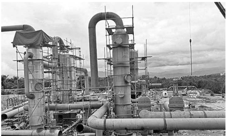
苏北省马第纳县疑似煤气泄漏
