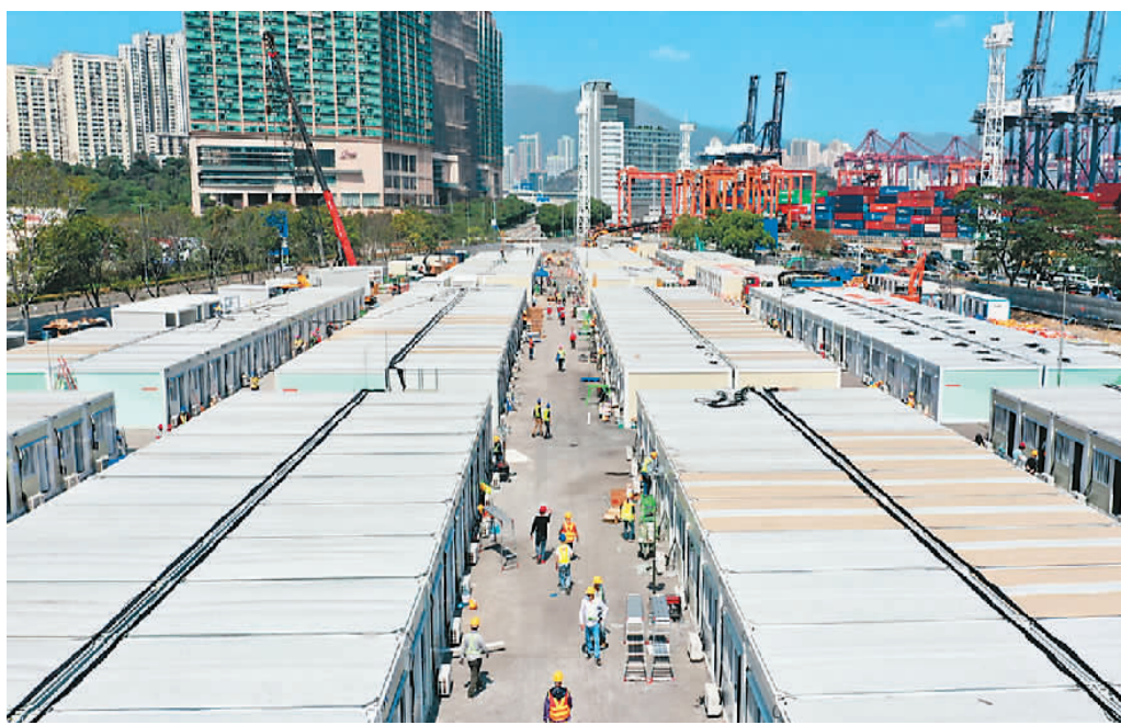
位于香港青衣的隔离设施正在紧张施工,即将完工并立刻投入使用。青衣“方舱医院”占地面积约6万平方米,可容纳超过3800张床位。图为隔离设施整齐排列。中新社记者 李志华摄
