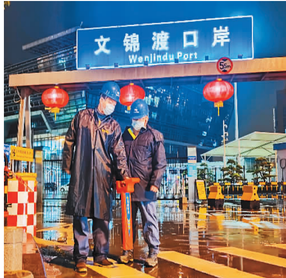
为协助香港应对新冠肺炎疫情、保障对港生鲜食品供应，南方电网近日组织工作人员做好口岸、深港跨境货运枢纽等重点用户和关键场所的保供电工作。图为南方电网深圳罗湖供电局工作人员在文锦渡口岸探测电缆线路。 叶杰摄
