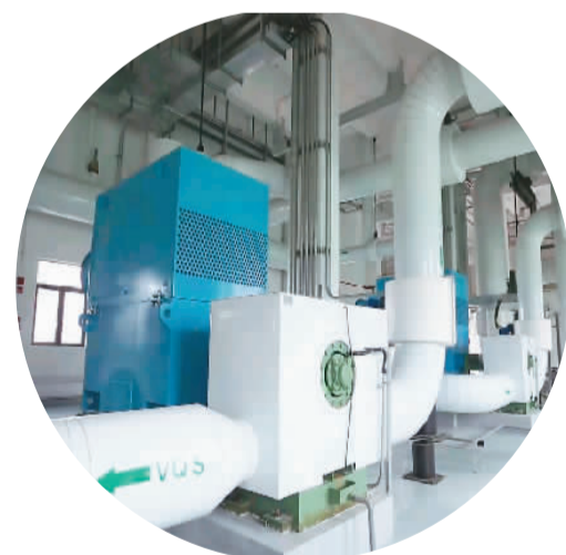
核能供热首站里的管道。资料图片
