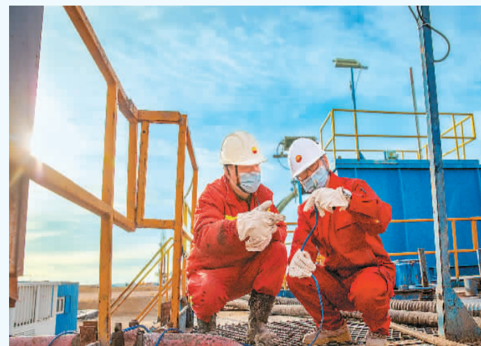
“油改电”是指将柴油用电替代作为钻机的动力，电驱钻机生产过程更加清洁环保，能源消耗大幅降低。图为中国石油新疆油田分公司玛湖油田生产现场，开发人员人员在油改电钻机现场检查线路。张 昉摄（人民图片）
