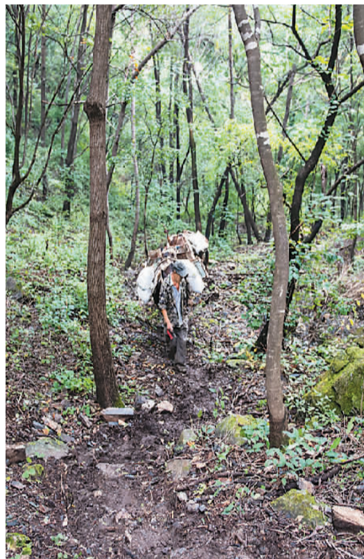
上图：自古至今，在险峻的山脊上修缮长城都非易事。这是9月28日在箭扣长城修缮现场拍摄的照片，工程材料主要依靠人力和牲畜通过陡峭的山径运抵山顶。另外，受现场条件制约，使用工程机械的程度很低，施工用水需从山脚通过三级水泵跨越三四百米高差送至工地。
