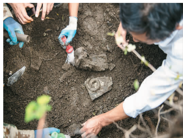
长城的修建从公元前3世纪持续到公元17世纪。它的主体部分包括城墙、马道、烽火台和屏障，还包括城墙上沿途的堡空和关隘。当代修缮时，也开始注重对长城周边环境的考古工作。图为在长城怀柔段170号敌楼抢险施工地，工人们为发掘出的房屋构件脊兽残片等进行清理。
