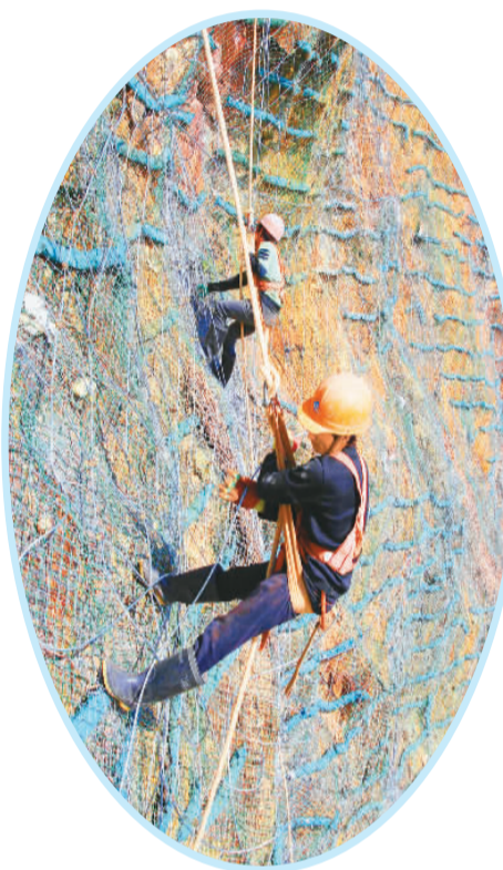
浙江省温岭市坞根镇新方废弃矿山边坡锚固绿化修复工地，工人正攀援在岩壁上，铺设和加固钩花钢丝绳，固化植绿。刘振清摄（人民图片）
