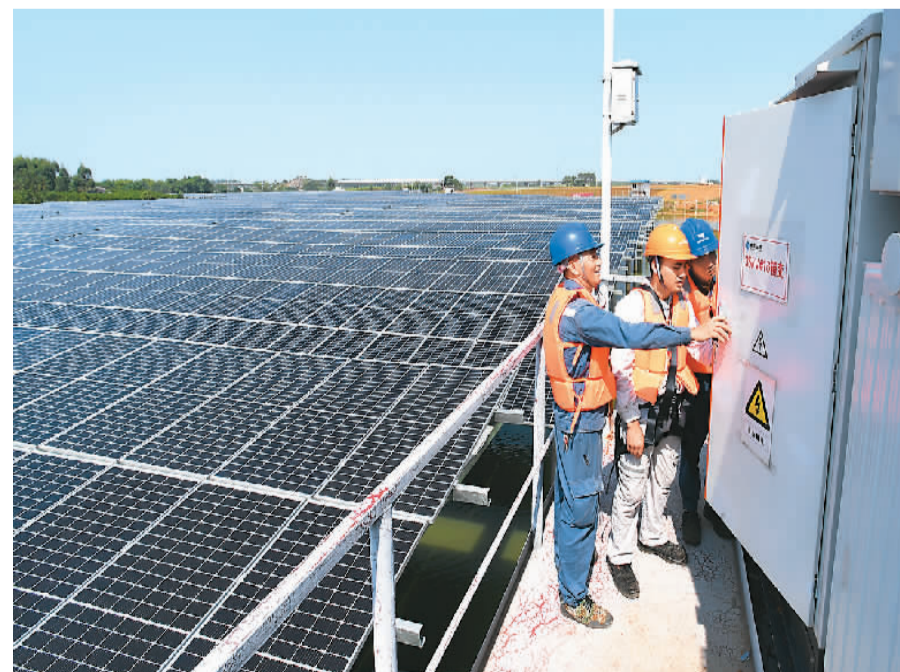
今年以来，广西南宁电力部门加快新能源送出通道建设，确保清洁能源100%送到电网。前三季度，累计有80亿千瓦时清洁能源进入电网，供千家万户使用。图为位于南宁市宾阳县古辣镇的100兆瓦光伏发电综合利用项目，南方电网南宁供电局工作人员对配套电网设施进行维护。 马华斌摄（人民视觉）
