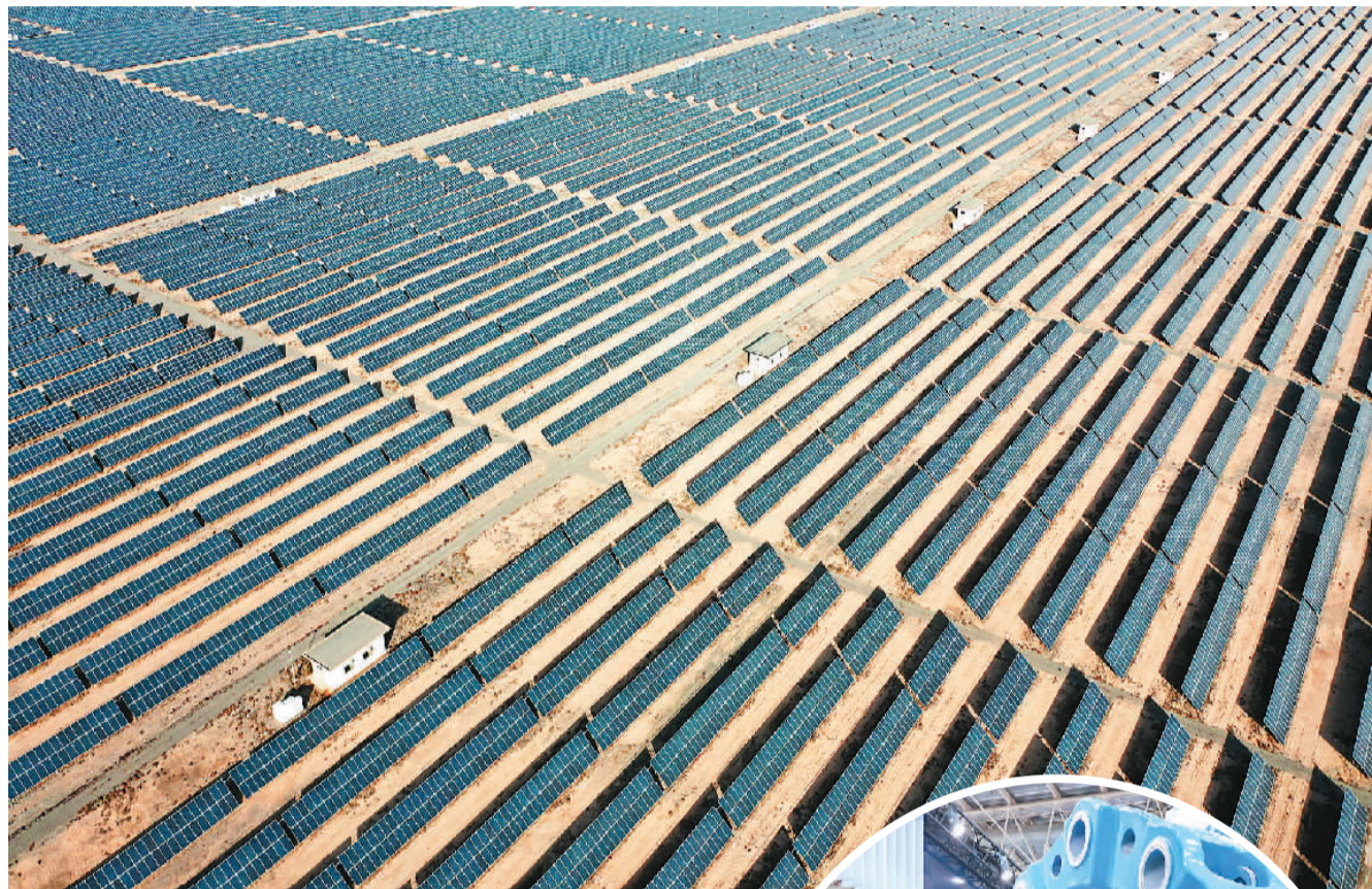
▲位于甘肃省张掖市甘州区的龙首滩光伏电站光电集阵。 杨永伟摄（人民视觉）
