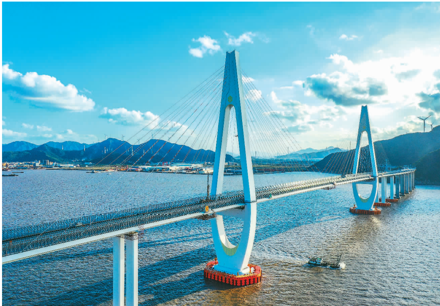
10月28日,随着最后一个施工吊篮的拆除,浙江省交通集团舟岱大桥南通航孔桥涂装施工顺利结束,这也标志着舟岱大桥主塔涂装施工全部完成。湛蓝的海面上,形似“玉净瓶”的白色主塔竖立其中,大小船舶穿梭而过,构成一幅灵动的画面,独特的钻石型塔身也成为舟山的代表性建筑。姚峰摄(人民视觉)
