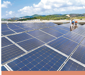
●福建平潭綜合實驗區風物流園拍攝的屋頂分布式光伏發電設施。資料圖片
