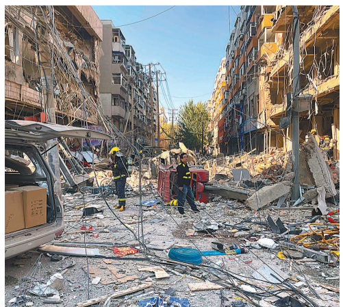
瀋陽市一家餐館發生爆炸，衝擊導致附近樓體受損，現場一片狼藉。
