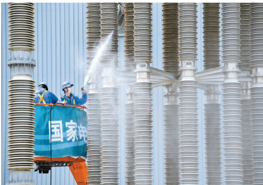
國網北京市電力公司延慶換流站的員工在清洗絕緣立柱。新華社
