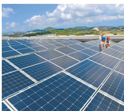
●福建倡導節能降碳，平潭綜合實驗區嵐台物流園使用屋頂分布式光伏發電設施發電。
